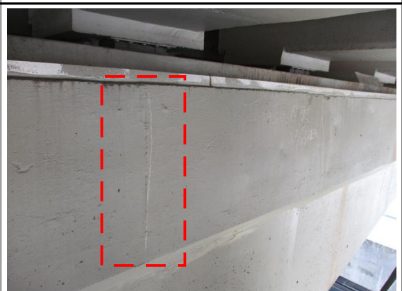
0.3mm 미만 균열 (P12-코핑부)
