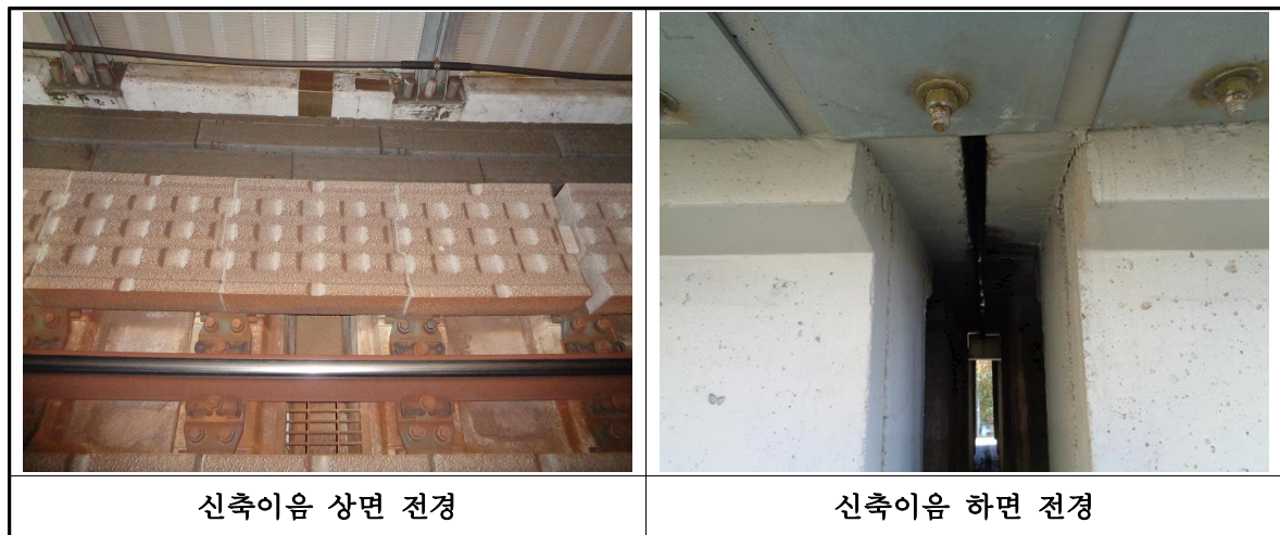
【그림 II-5.3.16】 신축이음 현황 및 조사 전경
